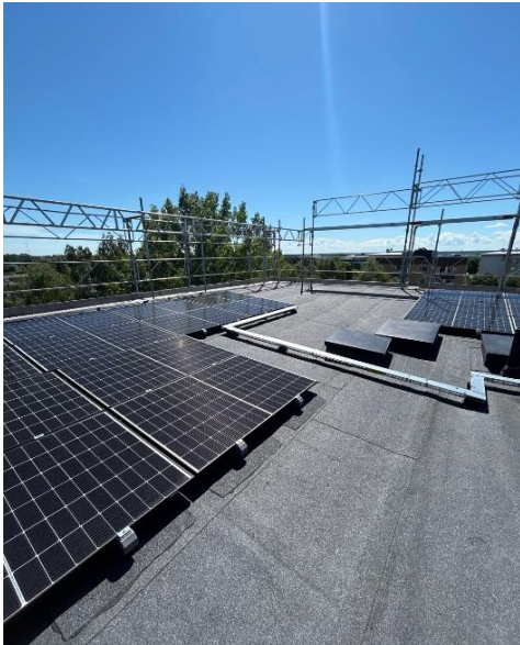
Solceller kring hela taket på samtliga hus.
